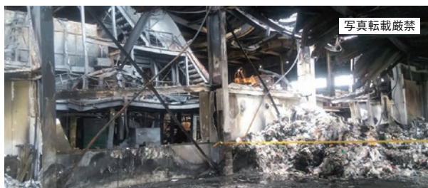
令和元年11月に発生したリサイクル工場での火災事故の様子
