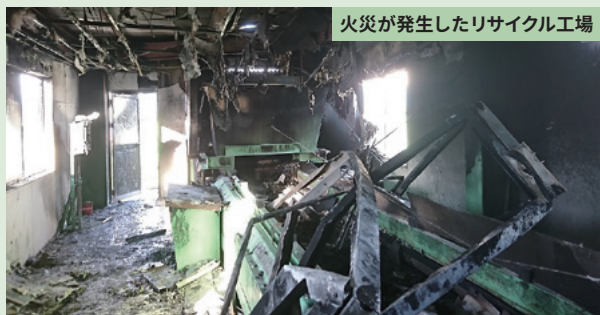
火災が発生したリサイクル工場
