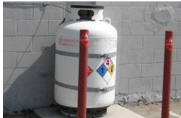
壁と固定された可燃性液体タンク
