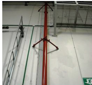
揺れ止めがされたスプリンクラー配管
