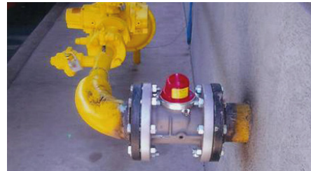
ガスラインの地震用緊急遮断弁
