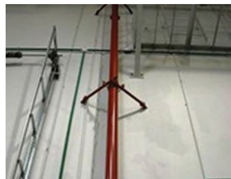
Tubería de rociadores con soporte antisísmico
