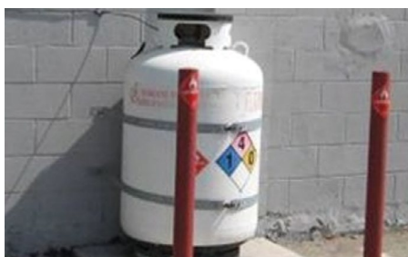
Tanque de líquido inflamable sujeto a la pared
