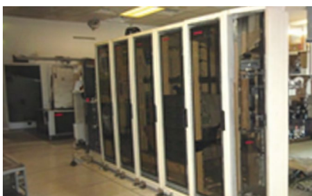
Soportes de servidores informáticos anclados al suelo
