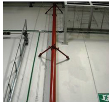
Sprinkler-Steigleitung mit Erdbebensicherung
