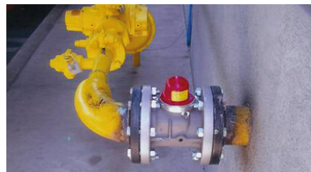
Erdbeben-Sicherheitsventil in der Gasversorgung
