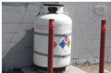
An der Wand befestigter Behälter für brennbare Flüssigkeiten
